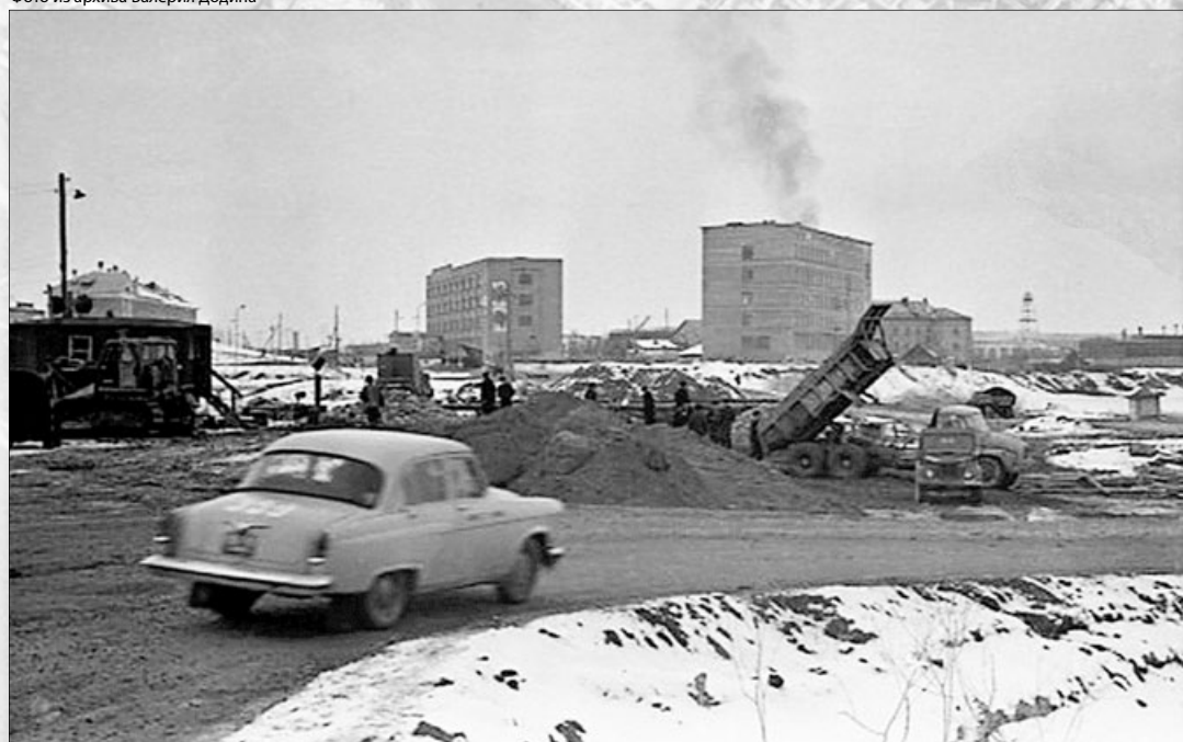
Строительство капитального моста через реку Чибью и ремонт дороги от улицы Мира в сторону улицы Севастопольской. 1970 год.
